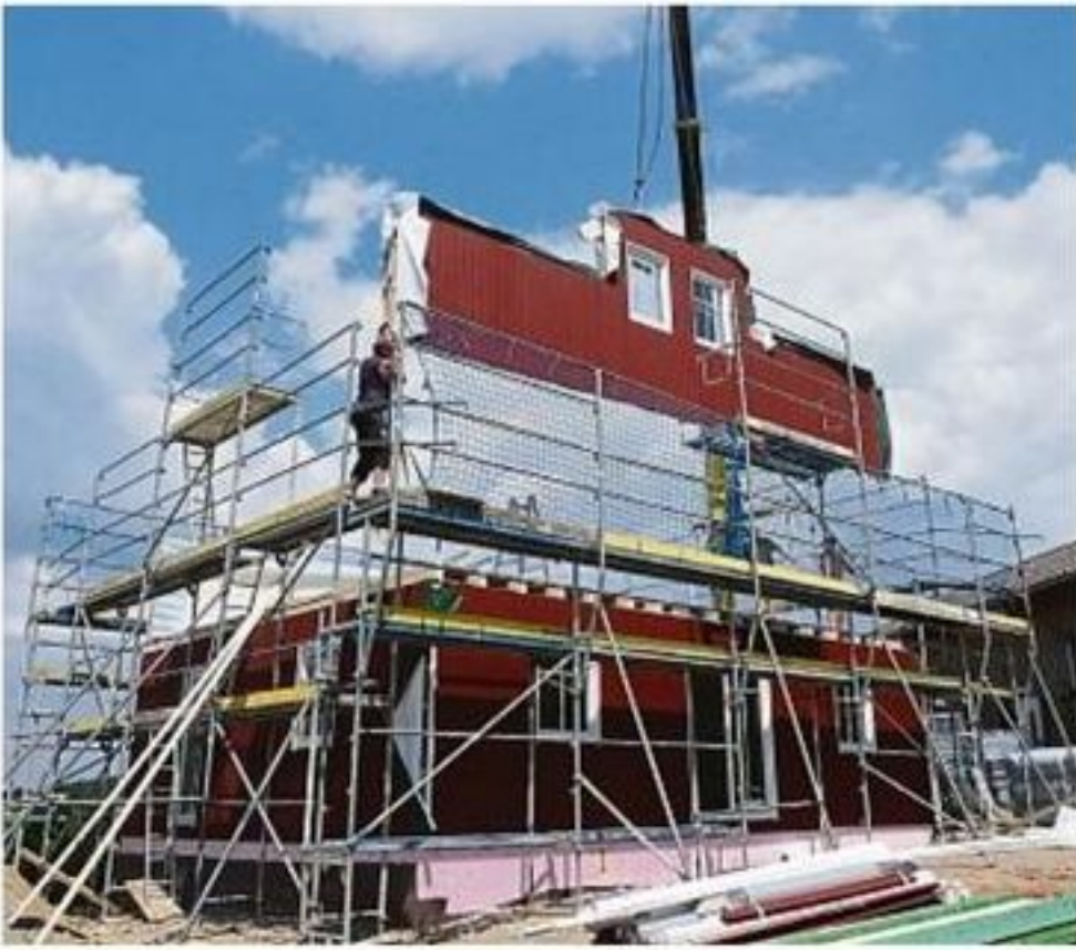
Ein Schwedenhaus in Holzrahmenkonstruktion: nach zwei Tagen war der Bau bereits dicht und der Innenausbau konnte starten.
